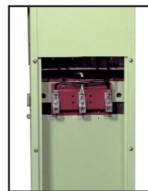
Utility Lug Landing
