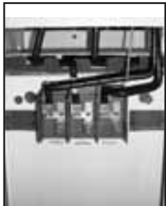
Utility Lug Landing
